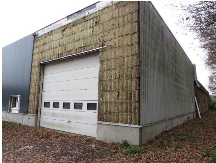
Bild 1: Hybrid-Sanierung einer Kassettenprofilfassade: Rückbau der Trapez-Außenschale (rechts) und vertikale Verlegung von direkt an den schmalen Kassettenurten befestigten PUR/PIR-Sandwichelementen (links)
