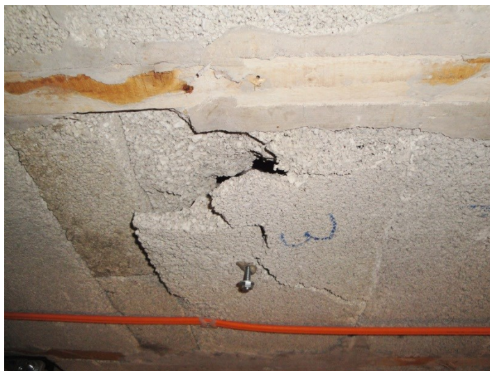
Bild 1: Bruchbild einer Hohlkörperdecke nach Probelastung
