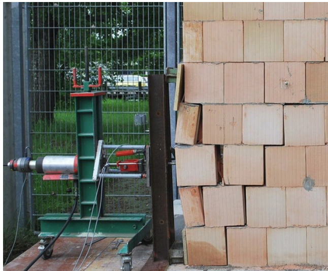
Bild 2: Bruch im Mauerwerk bei intakter Verankerung
