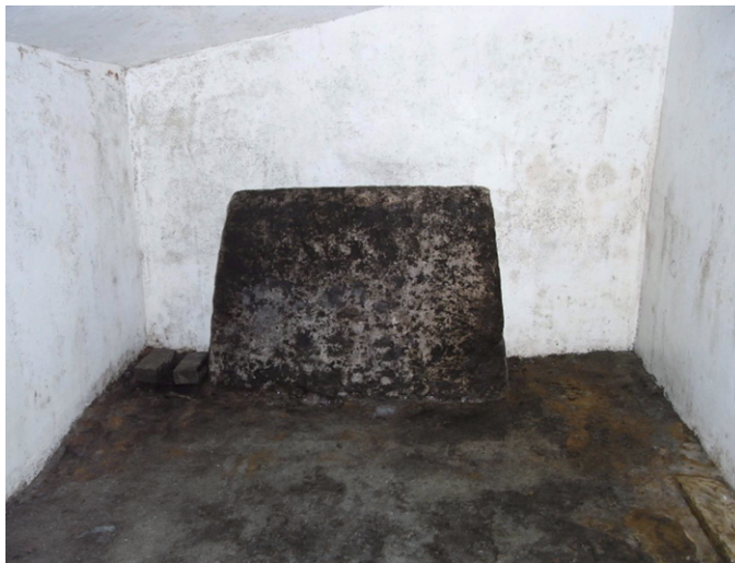
図2 暗色粘性物質が付着した扉石 (2011.11撮影)
