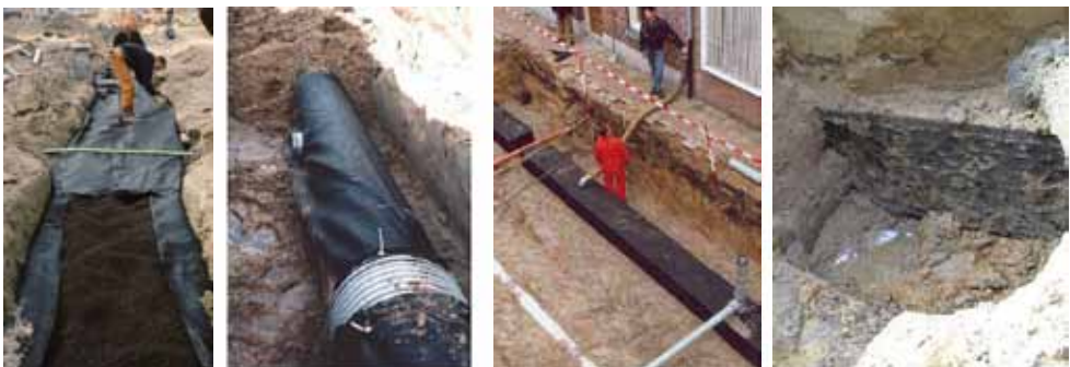
Figuur 2: Voorbeelden van eerste voorzieningen in Nederland (Schellerhoek te Zwolle, Stadshagen te Zwolle, Runstraat in Eindhoven (aanleg 1992 en opgraving 2006).
