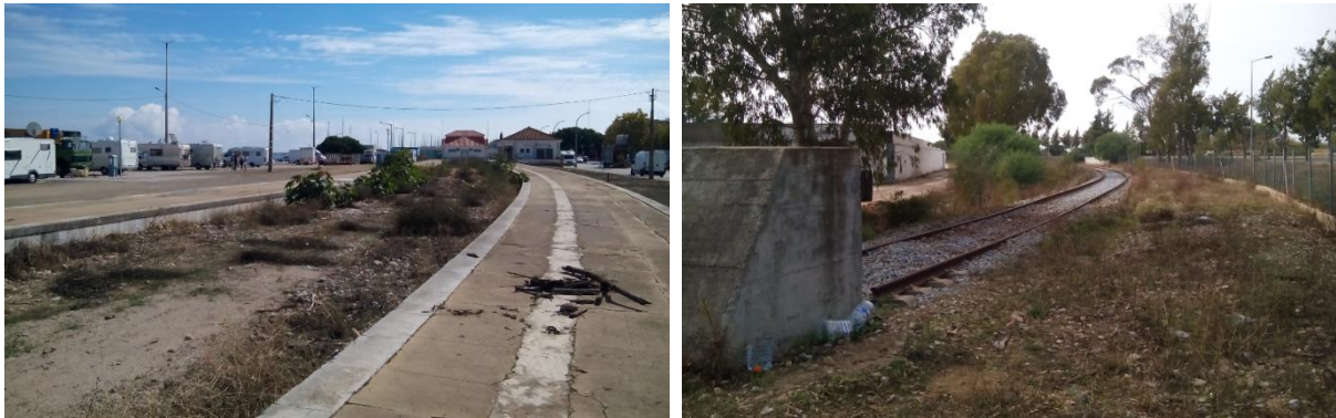
Figura 53 – Duas fotografias que ilustram as zonas degradadas do troço abandonado (Fonte: Autor).
