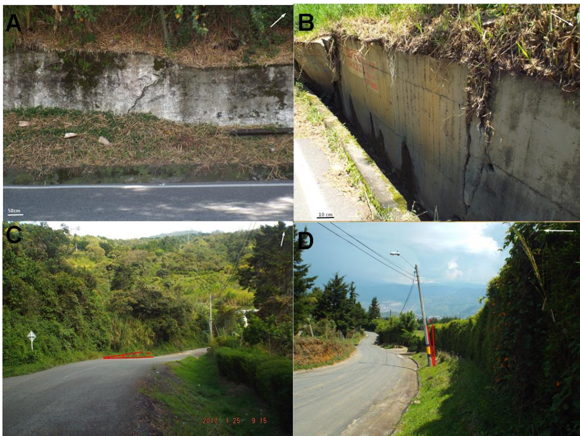
Figura 9.1.2: A) Falla de muro de contención por hundimiento de banca. B) Falla de muro de contención activa y por volcamiento hacia la vía. C) Hundimiento de la banca de aproximadamente 10°. D) Basculamiento de postes de luz de aproximadamente 7°.
