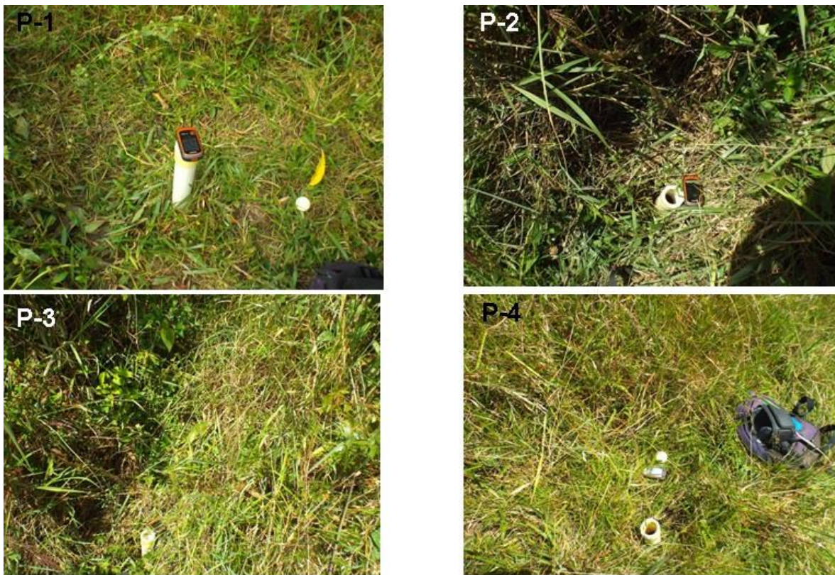
Figura 10.1.3.1: Piezómetros instalados en la zona centro de la zona.
