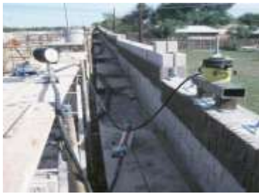
m) Sound walls (Woodham, 2001)
