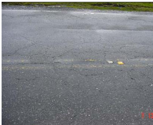
Figura 7. Agrietamiento en bloque
