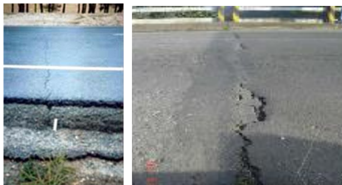
Figura 18. Fisura por reflexión de juntas
