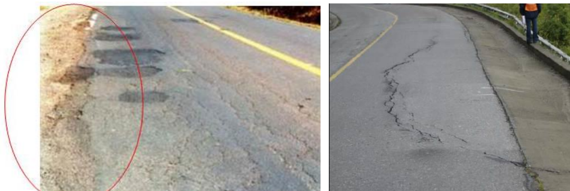
Figura 14. Fisuras y Grietas en Media Luna
