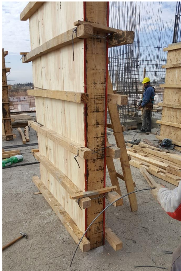
Figura 44 - Columna con fenólicos, travesaños y torniquete
