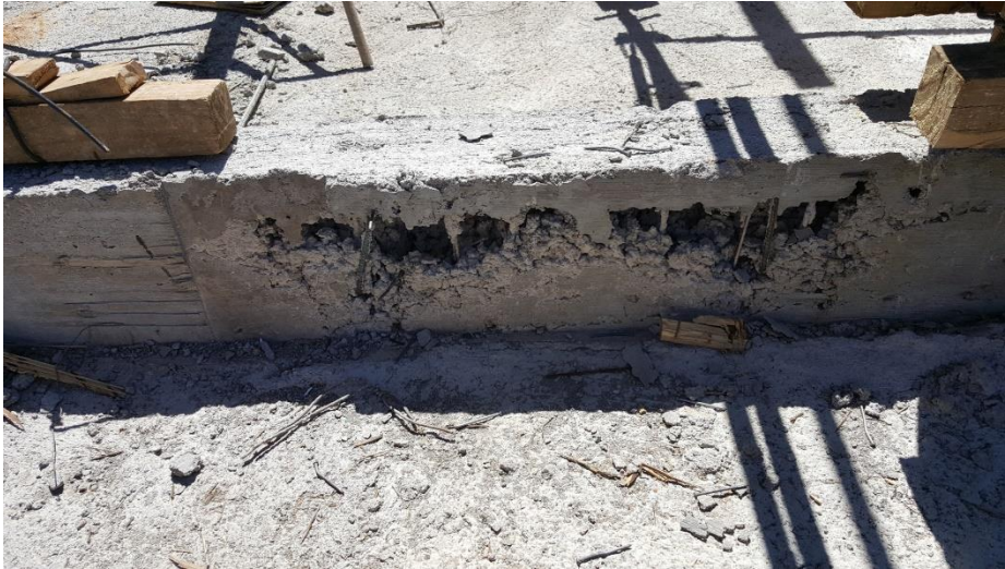
Figura 82 - Viga mal hormigonada
