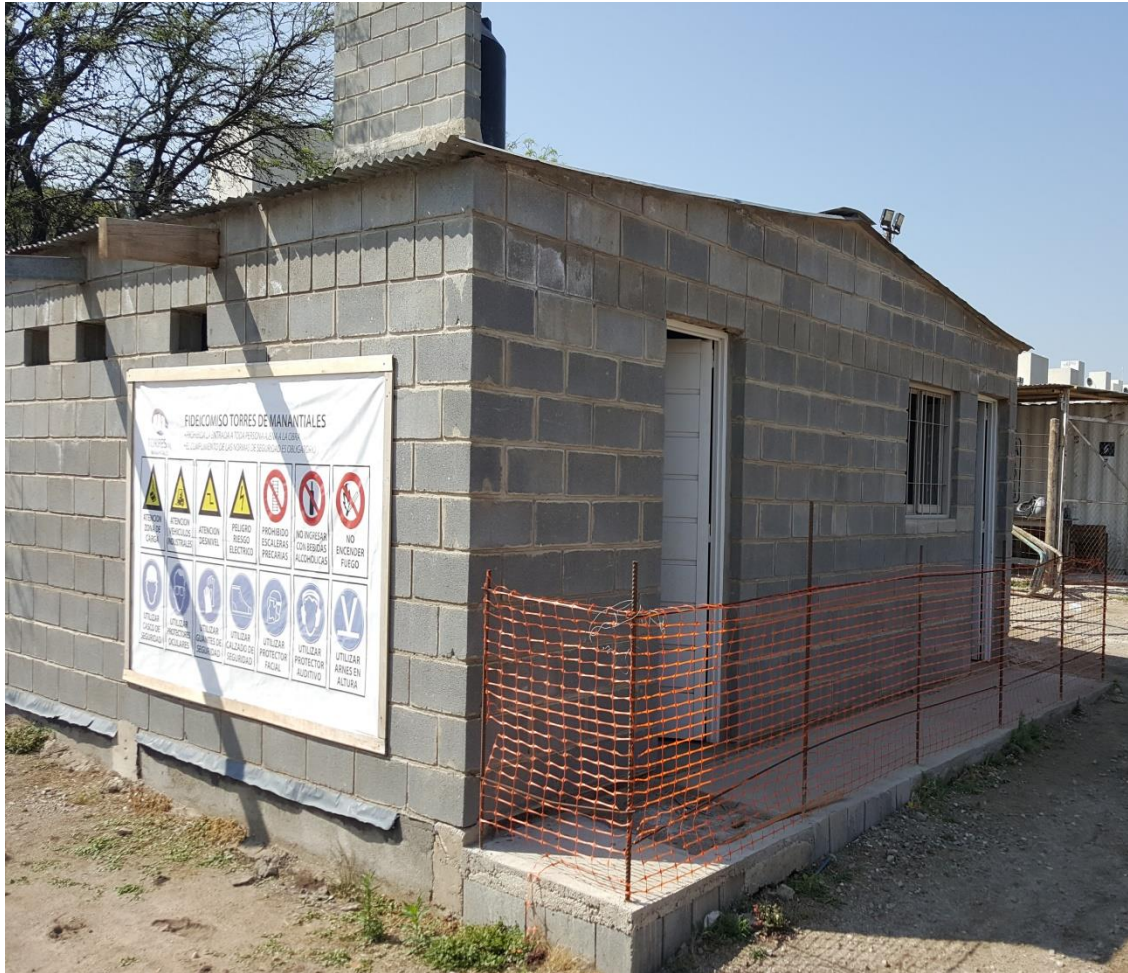
Figura 5 – Sanitarios, comedor y vestuario para los obreros
