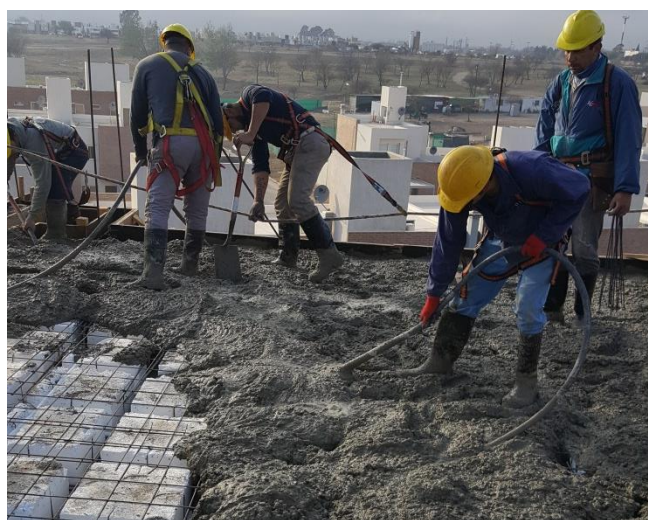
Figura 79 - Vibrador eléctrico y pala. Operario que introduce los anclajes para el encofrado de las columnas
