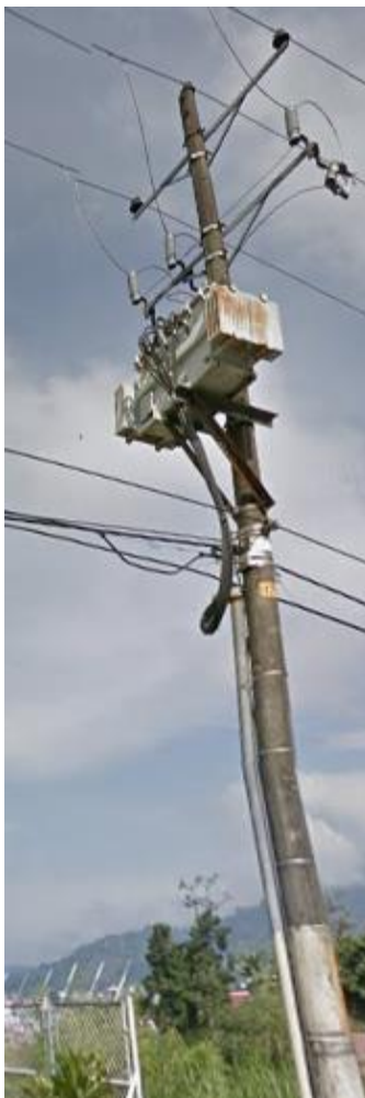
Figura 5-6.a. Nodo 1 circuito Ventorrillo 5
