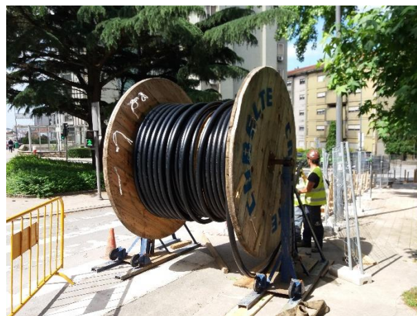
b) Bobina dos cabos AT
