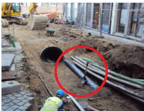
a) Coletor adjacente de águas pluviais
