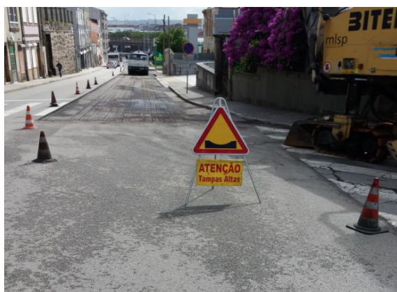
Figura 6.63 – Sinalização de segurança da obra.
