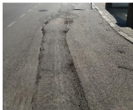
d) Pavimento provisório irregular
