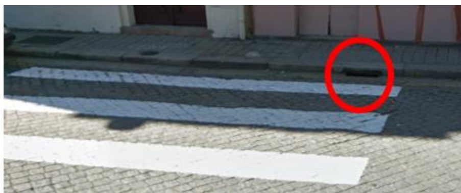
c) Sarjeta mal posicionada e ressalto no lancil
