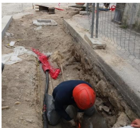
Figura 6.84 – Rede elétrica de baixa tensão.
