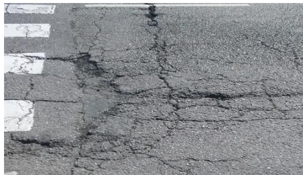
Figura 4.9 – Desagregação da camada de desgaste.
