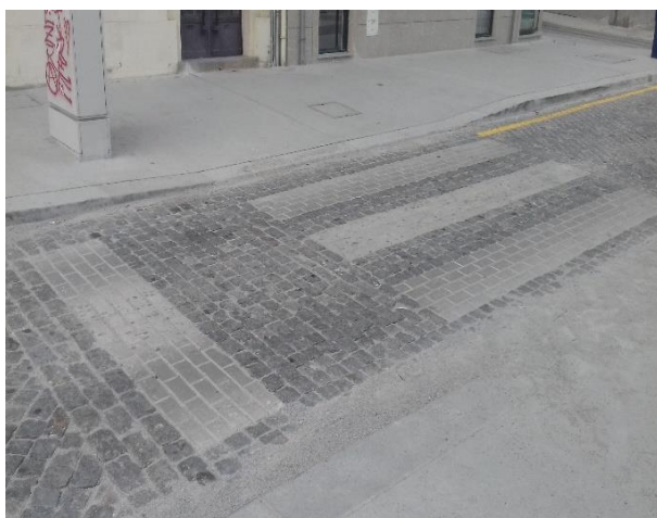
a) Rebaixamento parcial do passeio
