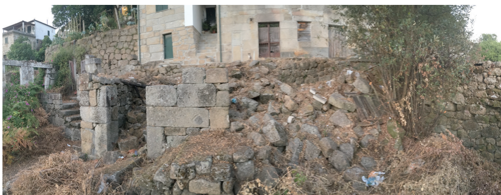
139 | Ruína voltada a poente. Outubro 2009 140 | Interior da ruína. Diferença entre pisos - diferentes espessuras da parede e reboco no primeiro piso. Agosto 2016 141 | Ruína do alçado sul do volume anexo. Agosto 2016
