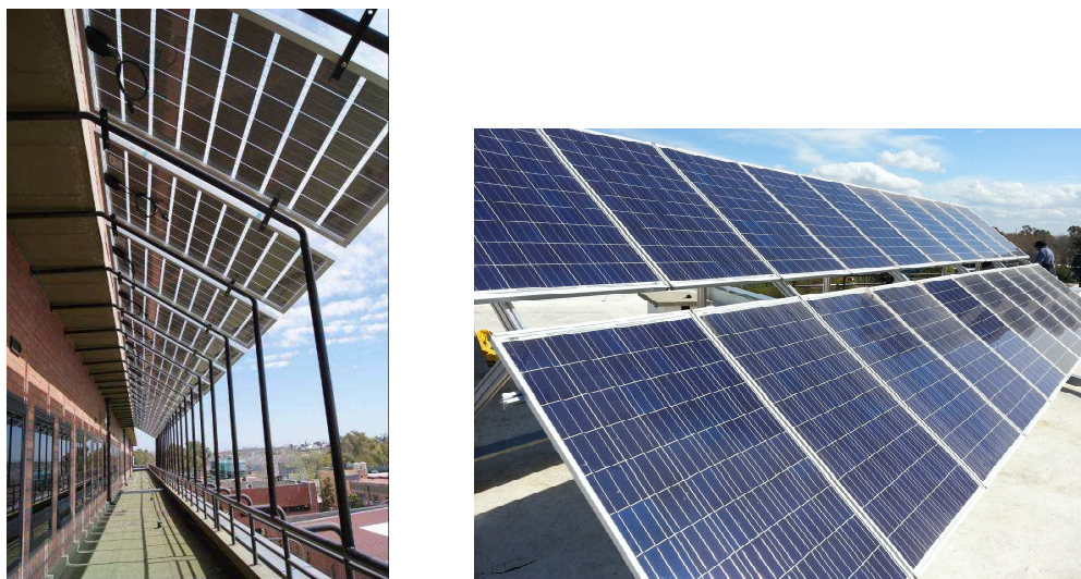
Figura 6.: Sistemas FV instalados en el edificio TANDAR (CAC):(i) pérgola FV con 23 módulos de 215 W p , ubicada en el tercer piso del edificio (izquierda); (ii) 20 módulos FV de 240 W p , ubicados en la terraza (derecha).
