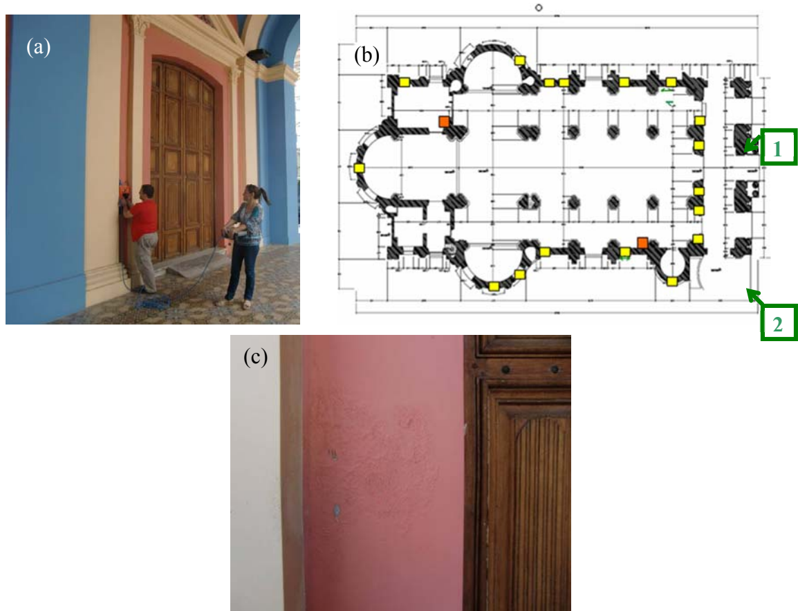
Figura 5. (a) Barrido con antena de 900MHz en dirección vertical en el sector [1] de la fachada del atrio; (b) sectores analizados en color amarillo y localización del equipo de deshumidificación en color naranja; (c) detalle de daño en pintura en sector [2].
