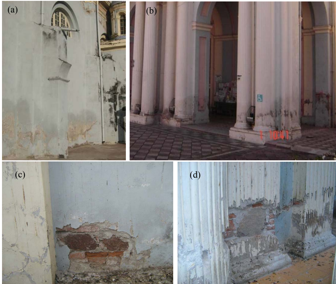
Figura 2. (a) y (b) Humedad en muros de fachada; (c) y (d) deterioro de revocos y mampuestos por el proceso de humedecimiento y secado.
