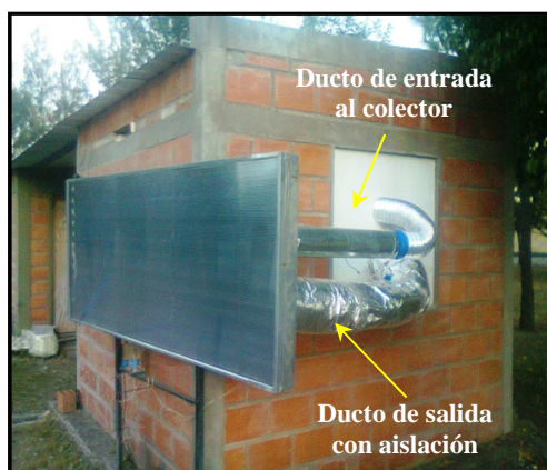
Figura 2: Colector solar conectado al prototipo de edificio.
