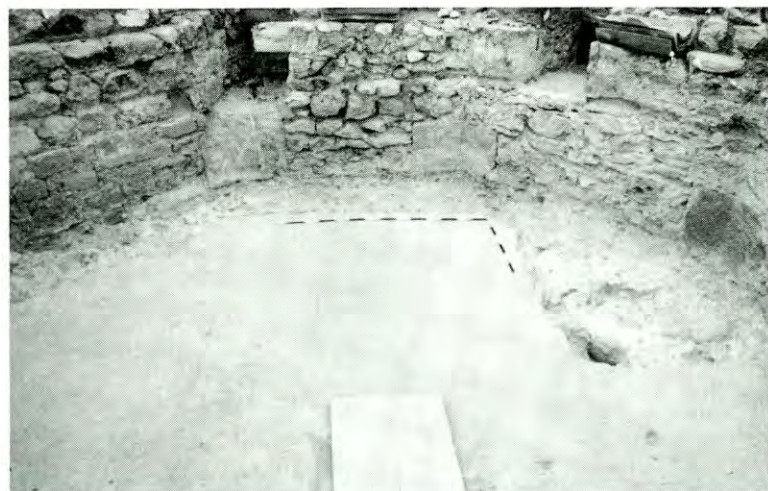
Figura 13. Aspectre del terrat amb el sondeig realitzat. S'observa el paviment UE 1017 i la volta UE 1025, a més de les UE III, IX, X, XIV, XV
