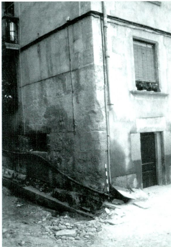
2.- Detall de l'edifici que es troba a la cantonada entre el C/ Misser Nogués i el C/ Escrivanes Velles. Es tracta de l'anomenada Casa Grases per Hernández Sanahuja on es pot apreciar que l'edifici actual aprofita, com a fonamentació i façana, l'estructura romana descoberta durant la intervenció arqueològica de 1994. Fotografia: I. Peña.
