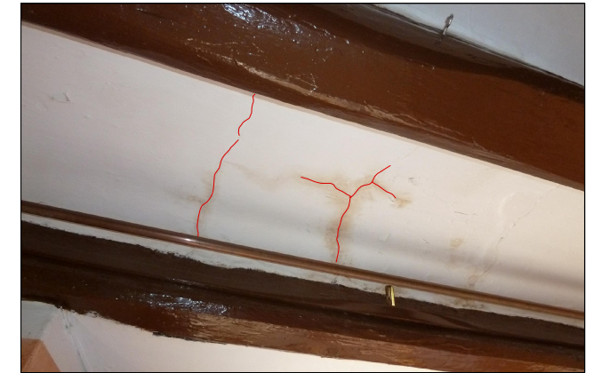
8. Humitat i fissura
