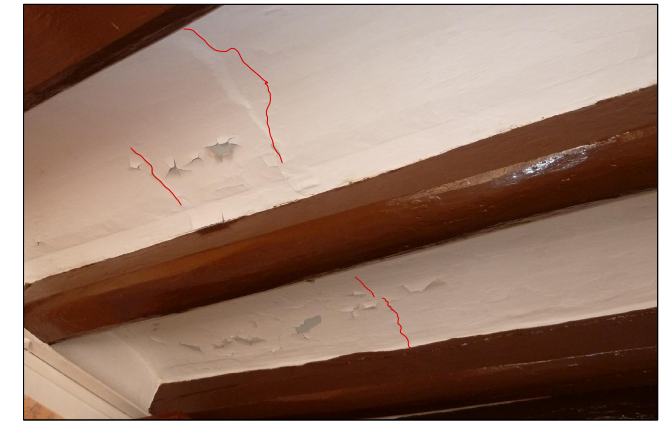
12. Fissura i escantellat del revestiment
