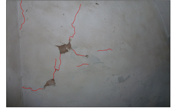
19. Humitat i fissura
