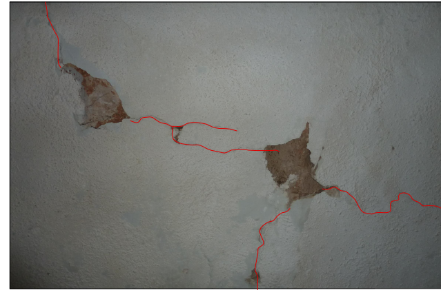
17. Humitat i fissura
