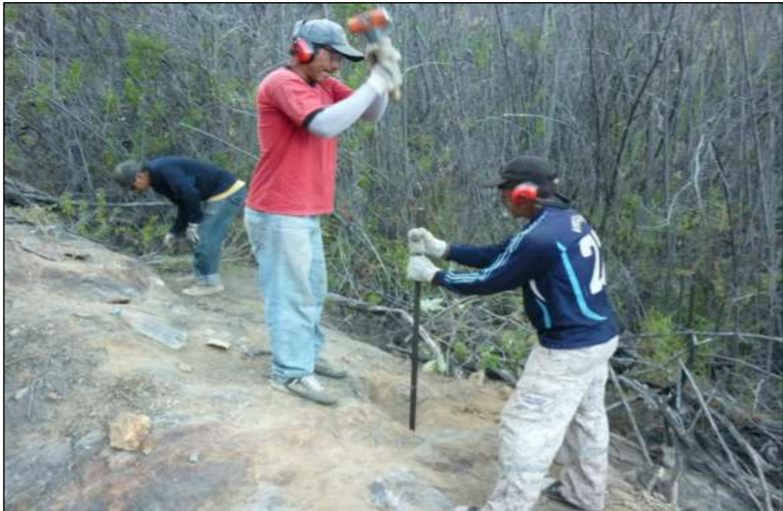
Figura 84: Realización de taladros para la utilización de explosivos, con la finalidad de exponer roca fresca.
