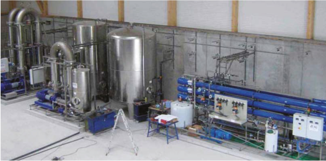
Kuva 23. Kalvosuodatuslaitteisto Inwillissä (A3 Water Solutions GmbH, 2018).
