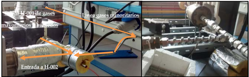
Figura 3-21 Tramo de conexión entre hornos y línea de gases minoritarios de la instalación UE1
