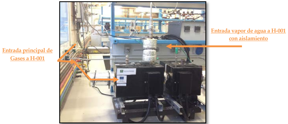
Figura 3-19 Entradas al horno precalentador (UE1-H-001)
