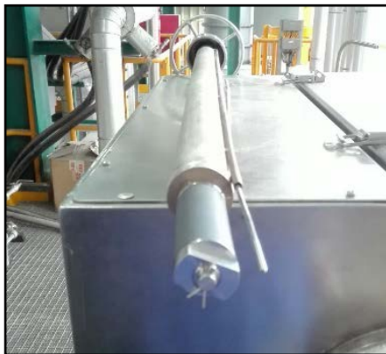
Figura 3–35 Imagen de la sonda de extracción de gases diseñada para la segunda unidad de ensayos
