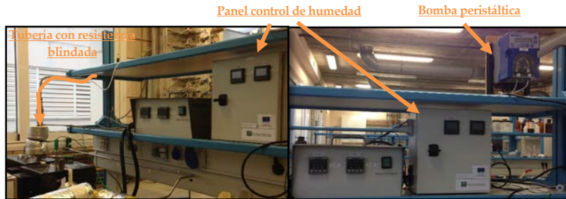
Figura 3-20 Sistema de generación de vapor de agua ( Tubería con resistencia blindada, panel de control de humedad, bomba peristáltica) desde dos perspectivas de la instalación UE1
