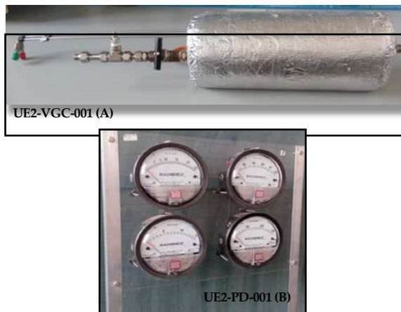
Figura 3–37 Venturi de gas calefactado con válvula de regulación de caudal implantado en el tren de muestreo (imagen A) y panel de medidores de presión diferencial tipo Magnehelic (Imagen B)
