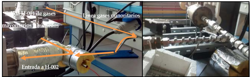
Figura 3-21 Tramo de conexión entre hornos y línea de gases minoritarios de la instalación UE1
