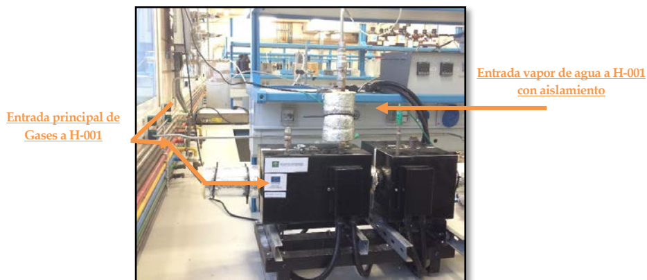
Figura 3-19 Entradas al horno precalentador (UE1-H-001)
