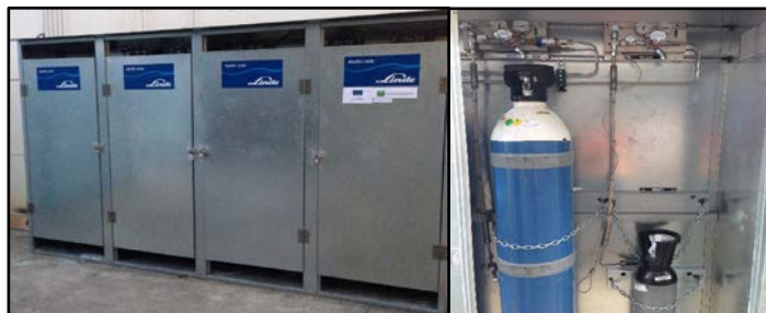
Figura 3-17 Caseta de gases más centrales descompresoras de la instalación UE1
