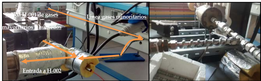
Figura 3-21 Tramo de conexión entre hornos y línea de gases minoritarios de la instalación UE1
