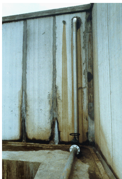
Foto 3: Detalle de la planta depuradora.
