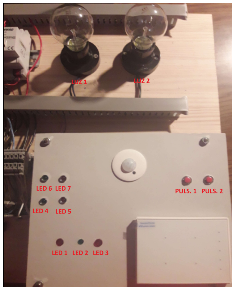
Figura 35. Luces, pulsadores y LEDs del sistema domótico
