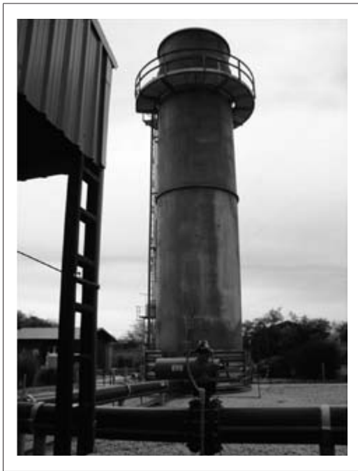
Foto 2. Planta de extracción y combustión de metano del relleno sanitario de Norte III
