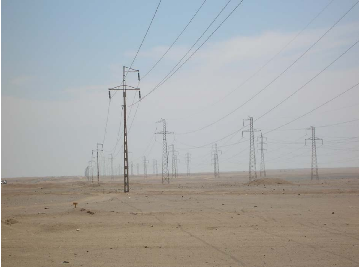
Photo N° 2 : Lignes à haute tension à proximité de Mejillones
