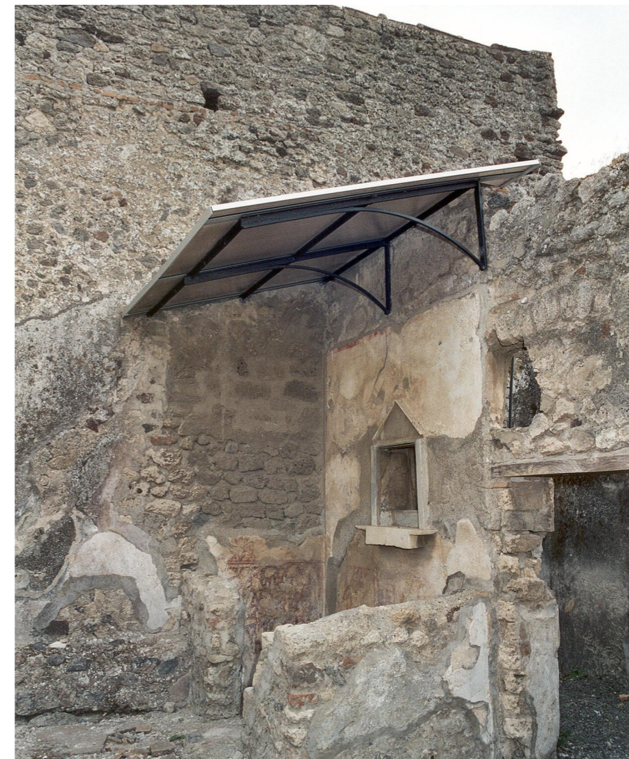
Vista della copertura a tettoia della zona del larario, a protezione del sottostante dipinto murale
