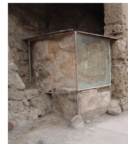
Particolari del preesistente dispositivo di protezione posto sulla caldaia: sottile struttura metallica e lastra di vetro. Il sistema si presentava degradato, opacizzato nella trasparenza del vetro e con mancanze che hanno innescato il progressivo degrado della caldaia
