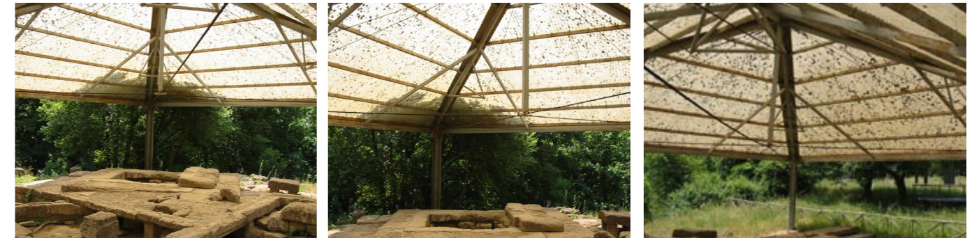
Immagini di dettaglio della struttura di copertura, dal basso. Sono visibili l'effetto traslucido del manto in materiale plastico e lo stato di degrado
