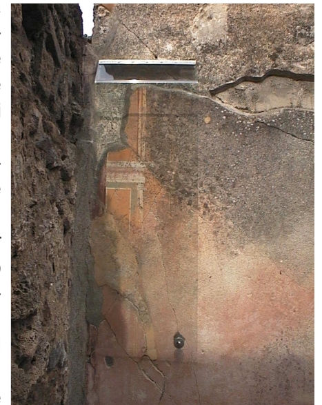
Dettagli della piegatura superiore imposta alle lastre al fine di proteggere i dipinti murali dall'infiltrazione di acque meteoriche e del sistema a cerniera che consente la manutenzione delle lastre e il monitoraggio dei dipinti
