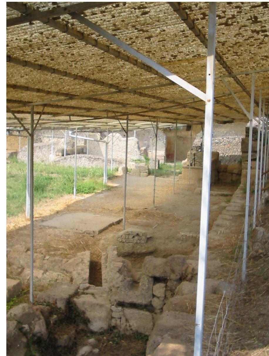
Vista dal basso del manto di copertura in lastre ondulate e traslucide; è visibile l'esile struttura metallica, l'interasse degli appoggi e lo stato di degrado del manto in materiale plastico
