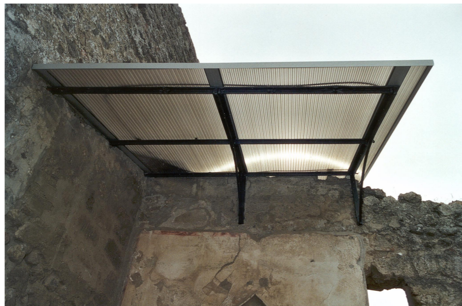
Vista della copertura della zona del larario; la tettoia è in lastre alveolari di policarbonato color bronzo
