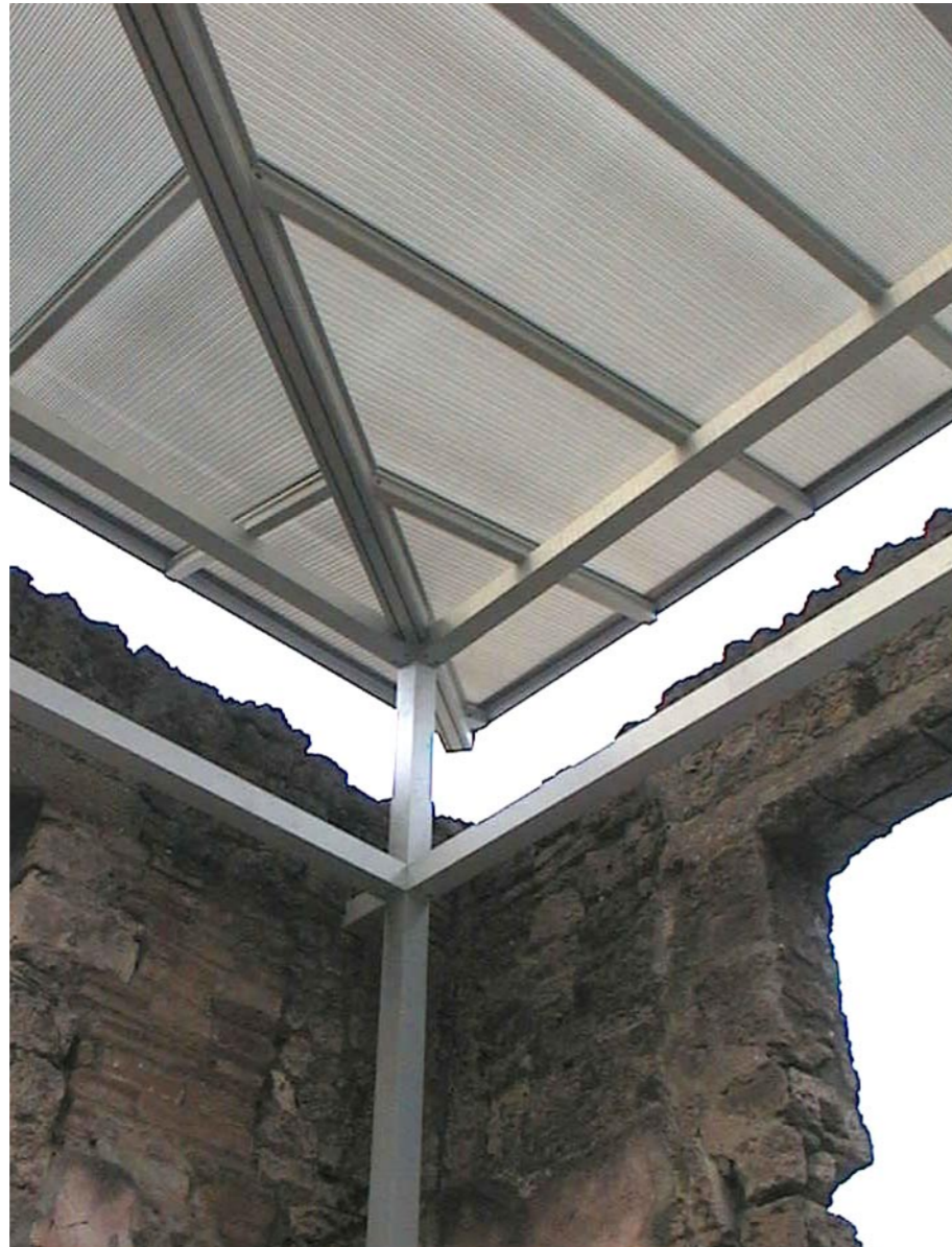
La chiusura orizzontale della struttura di copertura angolare dell'atrio; sono visibili le lastre alveolari traslucide di polycarbonato
