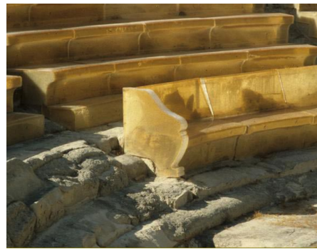
Le prime alterazioni del perspex e il progressivo distacco del materiale plastico
