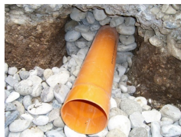
Fig. 381 Scuola dell'infanzia a Vedelago – loc. Casacorba (TV). Terminale del tubo forato in uscita dal perimetro dell'edificio (Foto: prof. G. Zannoni).
