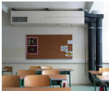
Fig. 371 Scuola per l'infanzia di Monguelfo (BZ) – EM2 Architetti. Dispositivo di ventilazione meccanica controllata di tipo decentralizzato con recuperatore di calore (Foto: EM2 Architetti).
