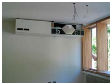
Fig. 423 Scuola primaria di Casteldarne (BZ) – EM2 Architetti. Dispositivo di ventilazione meccanica controllata di tipo decentralizzato con recuperatore di calore (Foto: EM2 Architetti).
