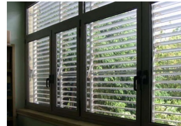
Fig. 443 Scuola primaria "R. Fucini", Roma – arch. Marcello Marocco in collaborazione con il Comune di Roma. Filtro solare esterno costituito da lamelle orientabili collegate a un dispositivo di regolazione dell'inclinazione delle lamelle stesse (Foto: AESSE)
