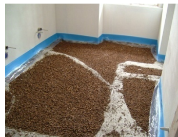
Fig. 459 Scuola primaria Marco di Rovereto (TN) – arch. Gianluca Perottoni. In alcuni ambienti, al di sopra massetto di integrazione impiantistica è stato posto uno strato di sugherite (sughero vetrificato, 6 cm) per la riduzione dei rumori da calpestio con sottostante strato di gomma (4 mm) per la separazione delle strutture (molla). (Foto: arch. Gianluca Perottoni).
