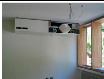
Fig. 390 Scuola primaria di Casteldarne (BZ) – EM2 Architetti. Dispositivo di ventilazione meccanica controllata di tipo decentralizzato con recuperatore di calore (Foto: EM2 Architetti).
