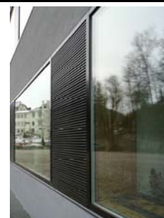
Fig. 434 Scuola primaria di Casteldarne (BZ) – EM2 Architetti. Griglia esterna di alloggiamento delle condotte di ventilazione integrata con il sistema vetrato.
