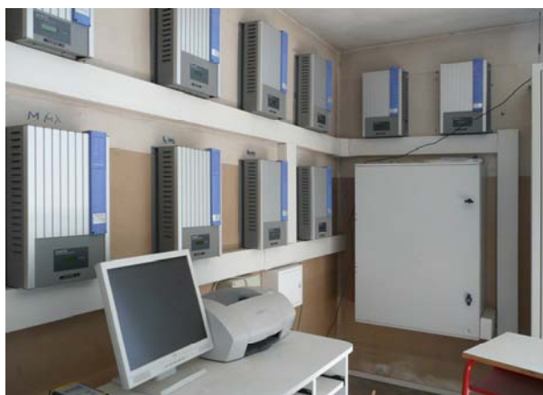
Fig. 250 Stazione di controllo del sistema fotovoltaico.
