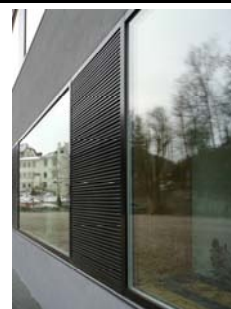
Fig. 392 Scuola primaria di Casteldarne (BZ) – EM2 Architetti. Griglia esterna di alloggiamento delle condotte di ventilazione integrata con il sistema vetrato.
