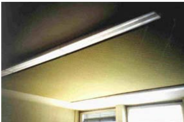
Fig. 101 Impianto di illuminazione delle aule prima dell'intervento.
