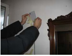
Fig. 348 Posizionamento della piastra termoflussimetrica sul lato interno della chiusura da valutare (Fonte: Pancaldi A., Papi A., Riqualficazione energetica , pag. 230, cfr. bibliografia).
