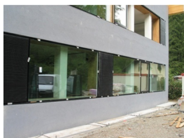
Fig. 455 Scuola primaria, Casteldarne (BZ) – EM2 Architetti. L'infisso è stato montato al filo esterno dell'isolante per mantenere continuità nella chiusura (Foto: EM2 Architetti)
