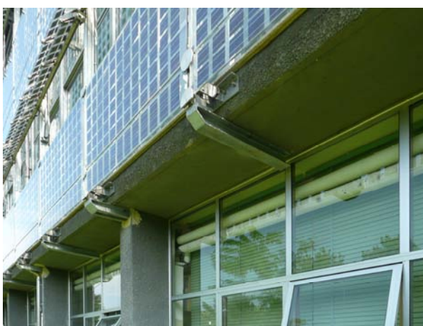
Fig. 254 Particolare dei profili metallici di ancoraggio della doppia pelle fotovoltaica alla struttura esistente.
