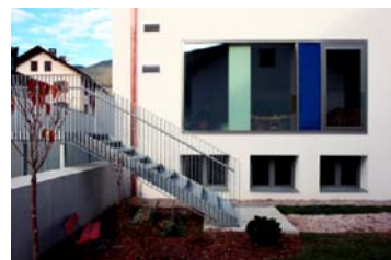
Fig. 431 Scuola per l'infanzia di Monguelfo (BZ) – EM2 Architetti. Griglie esterne di ventilazione in ingresso e in uscita (Foto: EM2 Architetti).
