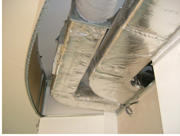
Fig. 454 Scuola primaria Marco di Rovereto (TN) – arch. Gianluca Perottoni. Le condotte per la ventilazione controllata sono state isolate da materassini con caratteristiche di isolamento termo-acustico. (Foto: arch. Gianluca Perottoni).
