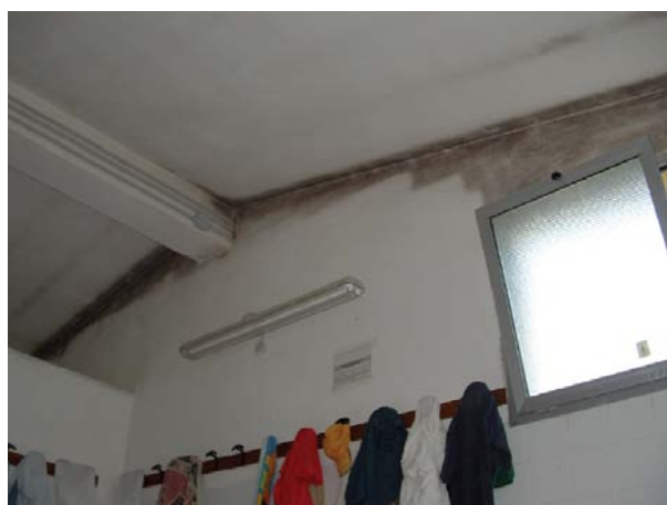
Fig. 279 Formazione di muffe in corrispondenza del ponte termico nel nodo parete-copertura all'interno di un locale adibito a spogliatoio (Fonte: prof. Arch. Pietromaria Davoli, Corso Avanzato "Architettura&Energia" , Reggio Emilia, 2007).
