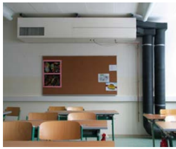
Fig. 411 Scuola per l'infanzia di Monguelfo (BZ) – EM2 Architetti. Dispositivo di ventilazione meccanica controllata di tipo decentralizzato con recuperatore di calore (Foto: EM2 Architetti).
