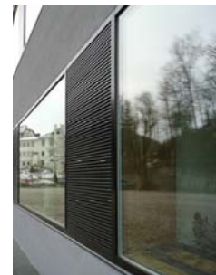
Fig. 416 Scuola primaria di Casteldarne (BZ) – EM2 Architetti. Griglia esterna di alloggiamento delle condotte di ventilazione integrata con il sistema vetrato.
