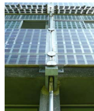
Fig. 368 Particolare dell'ancoraggio dei moduli fotovoltaici semitrasparenti sulla chiusura verticale esistente nell'Istituto Professionale di Stato per l'Industria e l'Artigianato di Rovigo.
