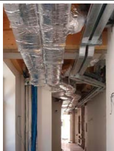
Fig. 393 Scuola primaria di Marco di Rovereto (TN) – Gianluca Perottoni Architetto. Impianto di ventilazione controllata di tipo centralizzato con recupero di calore. Particolare delle condotte coibentate alloggiato nel controsoffitto del corridoio di distribuzione (Foto: Gianluca Perottoni Architetto).
