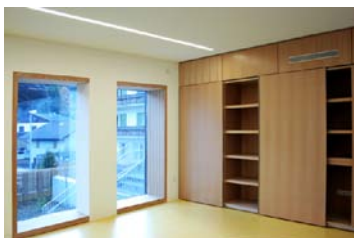
Fig. 430 Scuola per l'infanzia di Monguelfo (BZ) – EM2 Architetti. Elementi di arredo per l'alloggiamento del dispositivo di ventilazione (Foto: EM2 Architetti).
