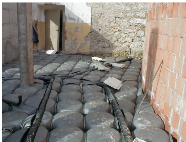
Fig. 194 Progetto: fase di cantiere relativa alla posa in opera delle in cupole di materiale plastico
