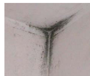
Fig. 275 Formazione di muffe sulla superficie interna di una chiusura verticale, in corrispondenza del nodo tra solaio e parete.
