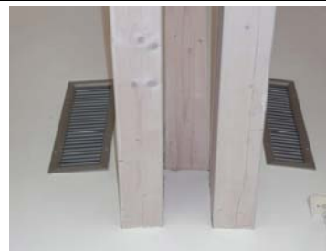
Fig. 395 Scuola primaria di Marco di Rovereto (TN) – Gianluca Perottoni Architetto. Griglie interne di immissione ed espulsione dell'aria all'interno di un'aula per attività speciali. Le griglie sono collocate nella partizione interna tra aula e corridoio.
