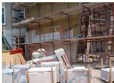
Fig. 457 Scuola primaria Marco di Rovereto (TN) – arch. Gianluca Perottoni. Posa in opera di isolante termo-acustico in lana di roccia (Foto: arch. Gianluca Perottoni).
