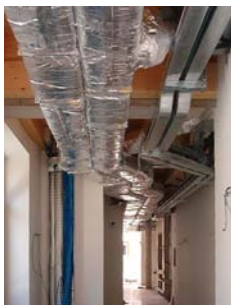
Fig. 417 Scuola primaria di Marco di Rovereto (TN) – Gianluca Perottoni Architetto. Impianto di ventilazione controllata di tipo centralizzato con recupero di calore. Particolare delle condotte coibentate alloggiato nel controsoffitto del corridoio di distribuzione (Foto: Gianluca Perottoni Architetto).
