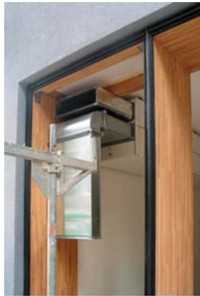
Fig. 181 Progetto: bocchette per la mandata e l'uscita dell'aria (vista dall'esterno durante la posa in opera).
