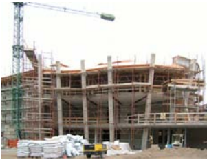
Fig. 364 Allestimento dell'area di cantiere durante la riqualificazione e l'ampliamento della scuola primaria di Marco di Rovereto (TN) (Fonte: arch. Gianluca Perottoni).
