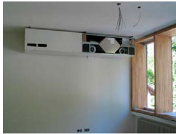
Fig. 374 Scuola primaria di Casteldarne (BZ) – EM2 Architetti. Dispositivo di ventilazione meccanica controllata di tipo decentralizzato con recuperatore di calore (Foto: EM2 Architetti).
