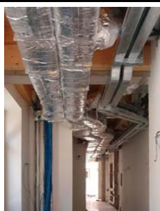
Fig. 435 Scuola primaria di Marco di Rovereto (TN) – Gianluca Perottoni Architetto. Impianto di ventilazione controllata di tipo centralizzato con recupero di calore. Particolare delle condotte coibentate alloggiato nel controsoffitto del corridoio di distribuzione (Foto: Gianluca Perottoni Architetto).
