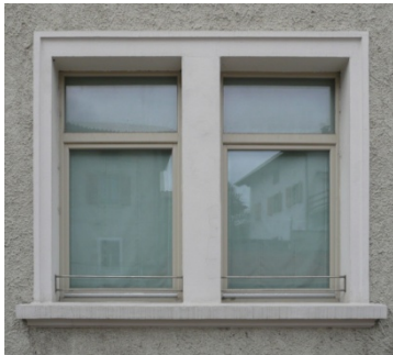
Fig. 438 Scuola primaria, Marco di Rovereto (TN) – arch. Gianluca Perottoni. Posizionamento di schermature interne flessibili a protezione della chiusura trasparente.
