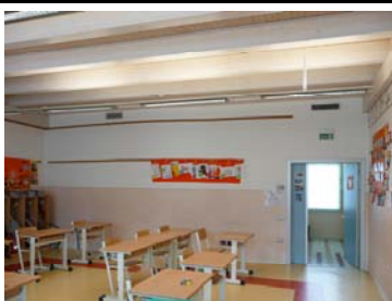
Fig. 436 Scuola primaria di Marco di Rovereto (TN) – Gianluca Perottoni Architetto. Griglie interne di immissione ed espulsione dell'aria all'interno di un'aula per la didattica. Le griglie sono collocate nella partizione interna tra aula e corridoio.
