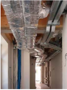
Fig. 426 Scuola primaria di Marco di Rovereto (TN) – Gianluca Perotoni Architetto. Impianto di ventilazione controllata di tipo centralizzato con recupero di calore. Particolare delle condotte coibentate alloggiato nel controsoffitto del corridoio di distribuzione (Foto: Gianluca Perotoni Architetto).
