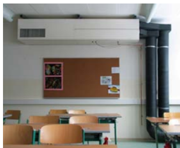
Fig. 429 Scuola per l'infanzia di Monguelfo (BZ) – EM2 Architetti. Dispositivo di ventilazione meccanica controllata di tipo decentralizzato con recuperatore di calore (Foto: EM2 Architetti).
