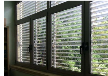
Fig. 451 Scuola primaria "R. Fucini", Roma – arch. Marcello Marocco in collaborazione con il Comune di Roma. Filtro solare esterno costituito da lamelle orientabili collegate a un dispositivo di regolazione dell'inclinazione delle lamelle stesse (Foto: AESSE)
