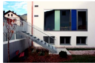
Fig. 373 Scuola per l'infanzia di Monguelfo (BZ) – EM2 Architetti. Griglie esterne di ventilazione in ingresso e in uscita (Foto: EM2 Architetti).
