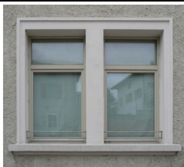
Fig. 403 Scuola primaria, Marco di Rovereto (TN) – arch. Gianluca Perottoni. Posizionamento di schermature interne flessibili a protezione della chiusura trasparente.
