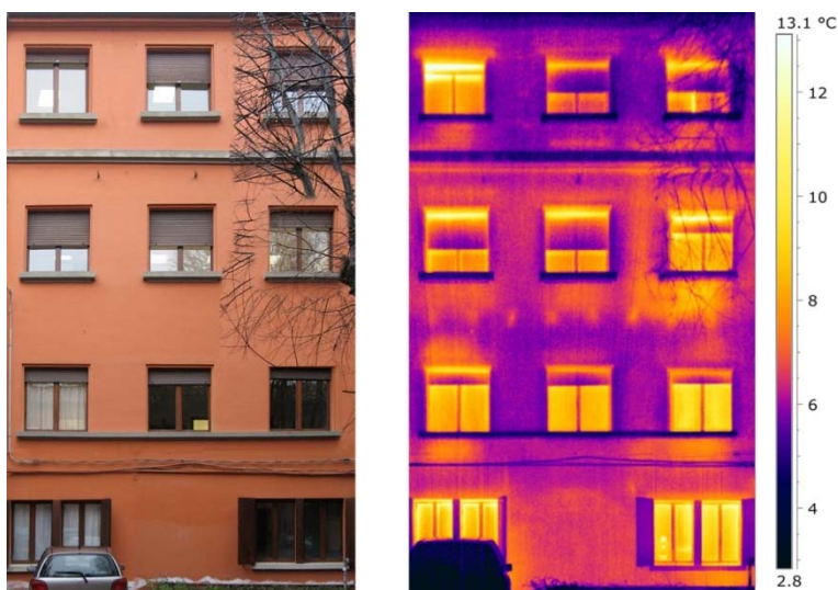
Fig. 352 Confronto tra fotografia (campo del visibile) e termogramma (campo dell'infrarosso). (Fonte: Pancaldi A., Papi A., Riqualificazione energetica. Procedure integrate ottimizzate di acquisizione, elaborazione e gestione di dati per la valutazione dell'efficienza del patrimonio edilizio e architettonico , cfr. bibliografia, Allegato 6).
