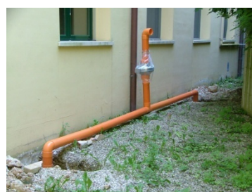
Fig. 384 Scuola primaria a Monselice (PD). Impianto di aspirazione a doppio tubo (Foto: prof. G. Zannoni).
