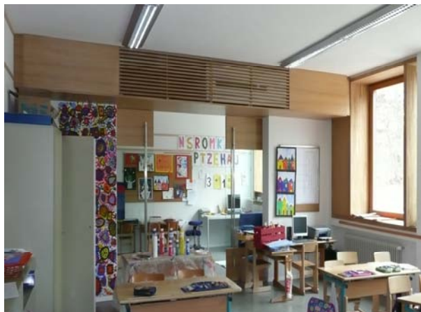
Fig. 183 Progetto: apparecchio per la ventilazione controllata inserito in apposito sistema di schermatura.
