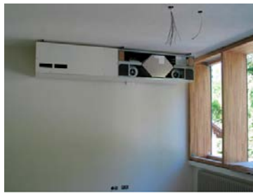
Fig. 414 Scuola primaria di Casteldarne (BZ) – EM2 Architetti. Dispositivo di ventilazione meccanica controllata di tipo decentralizzato con recuperatore di calore (Foto: EM2 Architetti).
