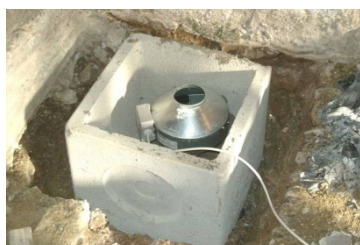
Fig. 385 Scuola secondaria di primo grado dell'"Istituto Comprensivo" di Lamon (BL). Dispositivo di ventilazione inserito all'interno di un pozzetto ispezionabile (Foto: prof. G. Zannoni).
