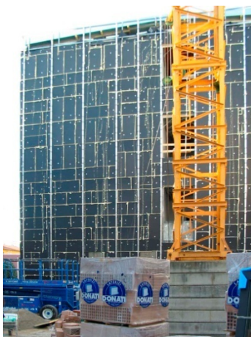
Fig. 401 Scuola per l'infanzia e primaria "Marconi", Firenze – Comune di Firenze. Posa in opera di pannelli in polistirene fissati con tasselli atermici. La finitura esterna prevede la posa di un rivestimento esterno in pannelli modulari in alluminio tipo "Alucobond" per la scuola primaria e la palestra e in pietra Santa Fiora per il corpo centrale (Foto: Comune di Firenze).
