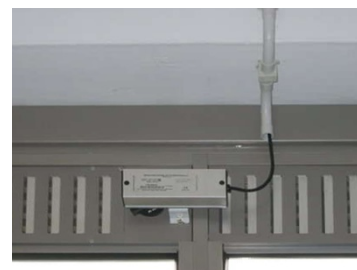
Fig. 399 Scuola secondaria di I grado "R. Fucini", Roma – Comune di Roma. Dispositivo attuatore per l'apertura automatica degli infissi (Foto: Comune di Roma).
