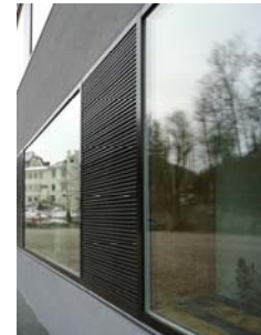
Fig. 376 Scuola primaria di Casteldarne (BZ) – EM2 Architetti. Griglia esterna di alloggiamento delle condotte di ventilazione integrata con il sistema vetrato.
