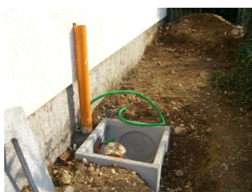
Fig. 383 Scuola dell'infanzia a Vedelago – loc. Casacorba (TV). Posizionamento del tubo esterno da collegare al dispositivo di ventilazione (Foto: prof. G. Zannoni).
