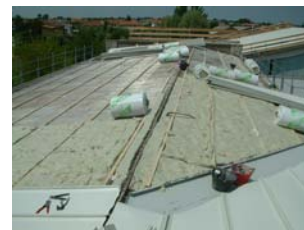
Fig. 74 Scuola primaria di Rovigo – frazione di Grignano Polesine: intervento di manutenzione straordinaria al coperto per inserimento di materiale isolante e sostituzione del manto di copertura (Fonte: Comune di Rovigo).
