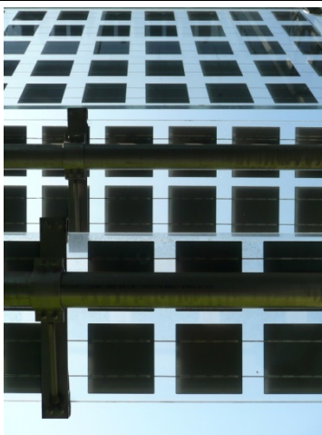
Fig. 453 Istituto Professionale per l'Industria e l'Artigianato, Rovigo – ing. Luigi Ferrari (Provincia di Rovigo). Il sistema prevede l'integrazione di lastre semitrasparenti fisse e di lamelle orientabili attraverso dispositivi a controllo elettronico.
