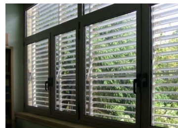
Fig. 408 Scuola primaria "R. Fucini", Roma – arch. Marcello Marocco in collaborazione con il Comune di Roma. Filtro solare esterno costituito da lamelle orientabili collegate a un dispositivo di regolazione dell'inclinazione delle lamelle stesse (Foto: AESSE)
