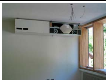
Fig. 432 Scuola primaria di Casteldarne (BZ) – EM2 Architetti. Dispositivo di ventilazione meccanica controllata di tipo decentralizzato con recuperatore di calore (Foto: EM2 Architetti).
