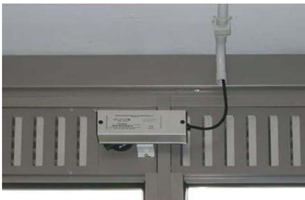
Fig. 239 Griglia di areazione ad apertura automatica posta sui vetri.
