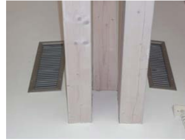
Fig. 428 Scuola primaria di Marco di Rovereto (TN) – Gianluca Perotoni Architetto. Griglie interne di immissione ed espulsione dell'aria all'interno di un'aula per attività speciali. Le griglie sono collocate nella partizione interna tra aula e corridoio.
