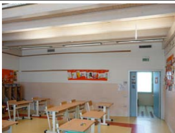
Fig. 394 Scuola primaria di Marco di Rovereto (TN) – Gianluca Perottoni Architetto. Griglie interne di immissione ed espulsione dell'aria all'interno di un'aula per la didattica. Le griglie sono collocate nella partizione interna tra aula e corridoio.
