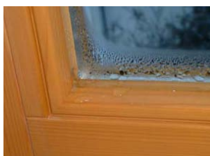
Fig. 278 Formazione di condensa sulla superficie interna vetrata di un infisso (Fonte: Arch. Manuel Benedikter, Corso per Esperti CasaClima , Dobbiaco, 2005).
