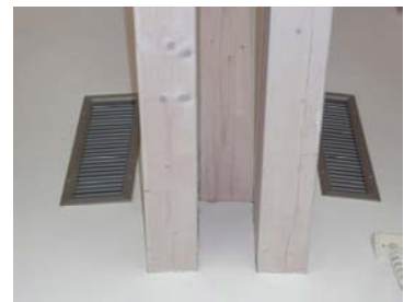
Fig. 419 Scuola primaria di Marco di Rovereto (TN) – Gianluca Perottoni Architetto. Griglie interne di immissione ed espulsione dell'aria all'interno di un'aula per attività speciali. Le griglie sono collocate nella partizione interna tra aula e corridoio.
