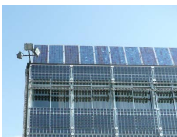
Fig. 462 Istituto Professionale per l'Industria e l'Artigianato, Rovigo – ing. Luigi Ferrari (Provincia di Rovigo). Moduli standard fissi in copertura.
