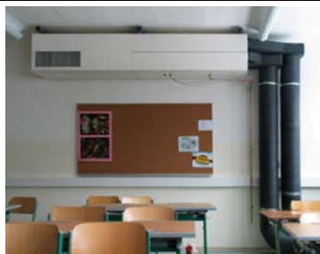
Fig. 387 Scuola per l'infanzia di Monguelfo (BZ) – EM2 Architetti. Dispositivo di ventilazione meccanica controllata di tipo decentralizzato con recuperatore di calore (Foto: EM2 Architetti).
