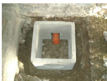
Fig. 382 Scuola secondaria di primo grado dell'"Istituto Comprensivo" di Lamon (BL). Inserimento del terminale del tubo forato all'interno di un pozzetto ispezionabile (Foto: prof. G. Zannoni).
