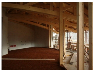
Fig. 460 Scuola primaria Marco di Rovereto (TN) – arch. Gianluca Perottoni. Anche i massetti per la diffusione del riscaldamento radiante a pavimento sono stati realizzati attraverso uno strato di sugherite (sughero vetrificato, 6 cm) per la riduzione dei rumori da calpestio con sottostante strato di gomma (4 mm) per la separazione delle strutture (molla). (Foto: arch. Gianluca Perottoni).
