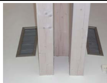
Fig. 437 Scuola primaria di Marco di Rovereto (TN) – Gianluca Perottoni Architetto. Griglie interne di immissione ed espulsione dell'aria all'interno di un'aula per attività speciali. Le griglie sono collocate nella partizione interna tra aula e corridoio.
