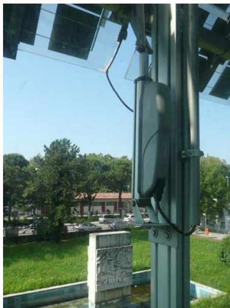
Fig. 253 Particolare del sistema di movimentazione delle lamelle.
