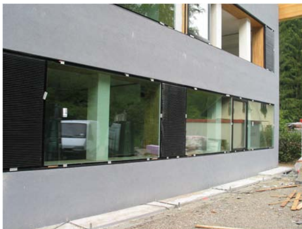
Fig. 170 Progetto: gli infissi sono montati al filo esterno della parete perimetrale verticale e integrano la griglia per il sistema di ventilazione controllata degli ambienti (fase di cantiere).
