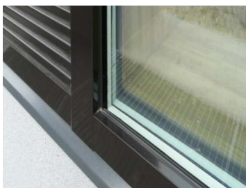
Fig. 398 Scuola primaria, Casteldarne (BZ) – EM2 Architetti. Il progetto di riqualificazione ha previsto l'adozione di infissi in alluminio a taglio termico con doppio vetrocamera basso emissivo.
