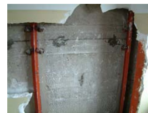
Fig. 70 Scuola secondaria di I grado "G. Parenzo" di Rovigo: pannelli prefabbricati di chiusura verticale montati su profili in acciaio (Fonte: Comune di Rovigo).
