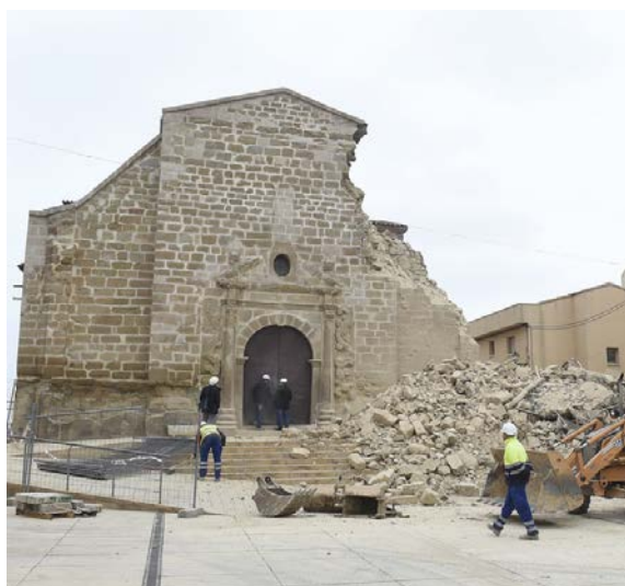
Figura 11. Iglesia de Roselló después del colapso del campanario y las partes inferiores. Foto Diari El Punt-Avui
