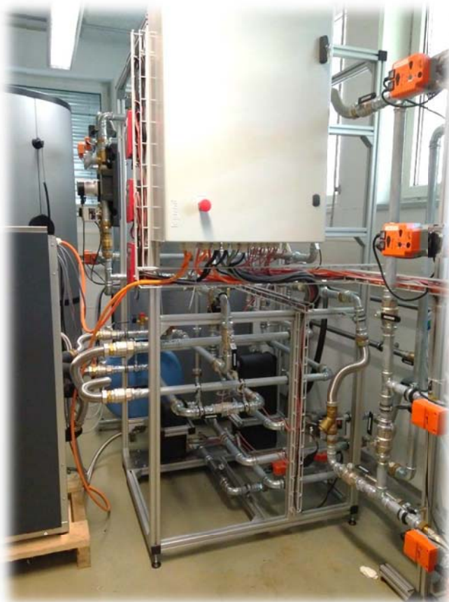
Abbildung 30 Anlage mit Steuerschrank
