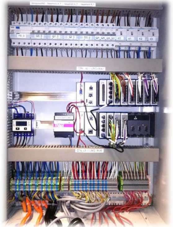
Abbildung 29 Steuerschrank von Innen
