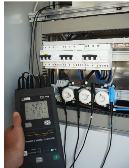
Abbildung 13: Messungen mit dem PEL im Elektroschrank in Steg
