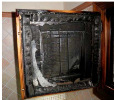
Imagen 15. Ventana que ha evitado el paso de las llamas.
