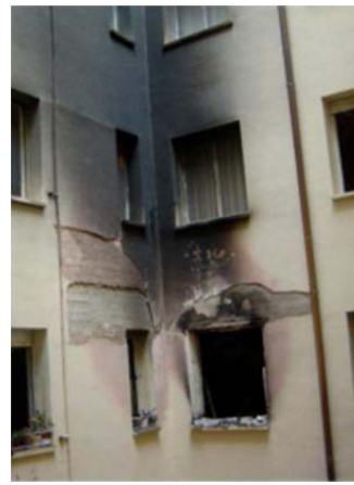
Imagen 13. Distancia insuficiente entre ventanas.
