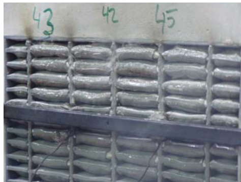
Imagen 30. Rejilla expandida debido al calor producido por las llamas.
