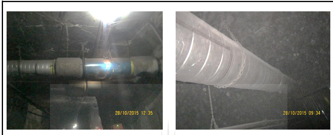
Figure 37: 75 KW Booster fan
