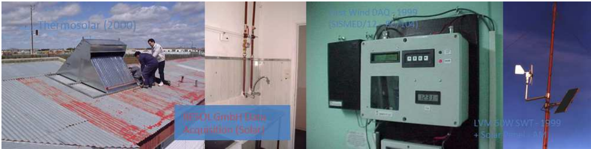
Figura 3: – Colector solar térmico de tubos e instrumentación AEA, sistemas relacionados
