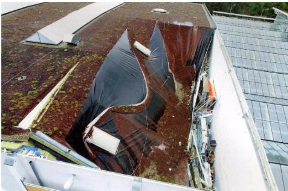
Figura 14: Colapso da estrutura pelo inadequado sistema de drenagem instalado (Prates, 2012)
