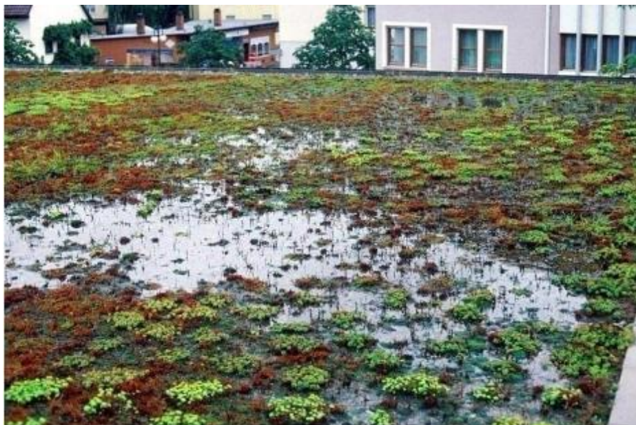
Figura 15: Cobertura Verde com problemas de acumulação de água (Prates, 2012)
