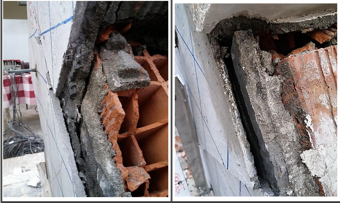
Şekil 3.47: G-6-A-2 numunesi ile duvar arasındaki boşluklar.
