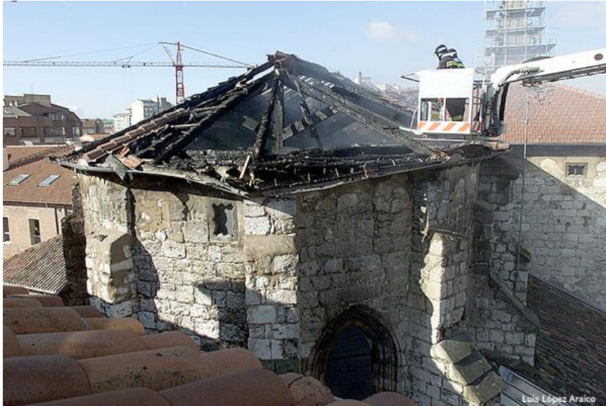
Figura 5.1: Estado de la cubierta después del incendio
