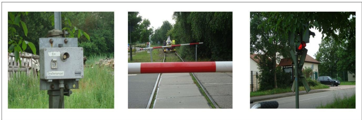
Abbildung 15: Schrankenanlage bei der Südpfalz-Draisinenbahn
