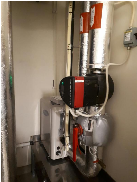
Bilde 2. Innerdel til varmepumpe ved sykehjem i Halsa. Foto: Halsa kommune
