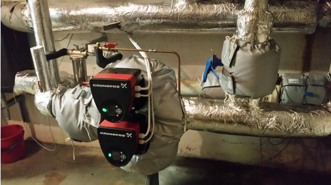
Bilde 17. Skifte av pumper og isolering av rør, Tingvoll barne- og ungdomsskole. Foto: Bjørn Hammerfjell
