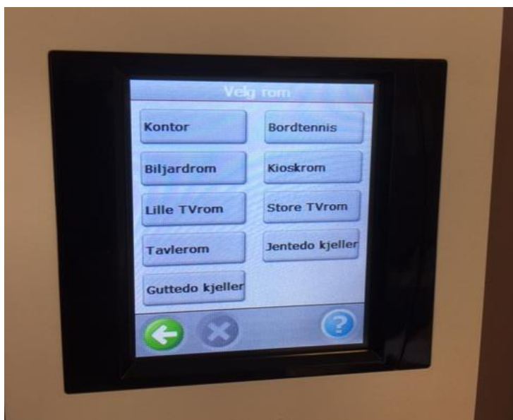
Bilde 9. Gamle Øra skole, styrepanel for romstyring opp mot trådløse aktuatorer.
