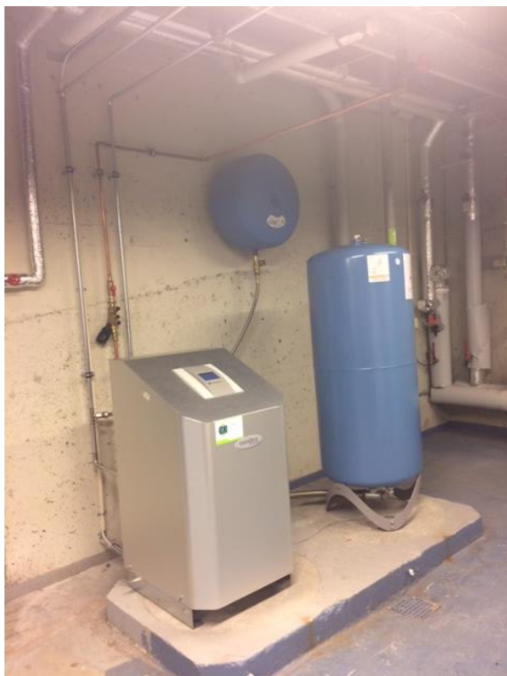
Bilde 10. Trykkvedlikeholdssystem-anlegg med automatisk etterfylling av vann. Det tar ut en delstrøm fra varmeanlegget, som blir vakuumert for å trekke oksygen av vannet, som igjen blir ført tilbake til varmeanlegget.
