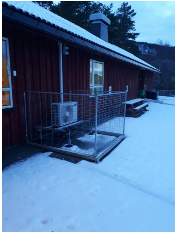
Bilde 3. Ytterdel til varmepumpe ved Valsøyfjord barnehage. Foto: Halsa kommune
