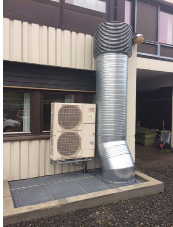
Bilde 13. Utedelen til varmepumpen er montert over avkastet fra ventilasjonsanlegget. Foto: Surnadal kommune
