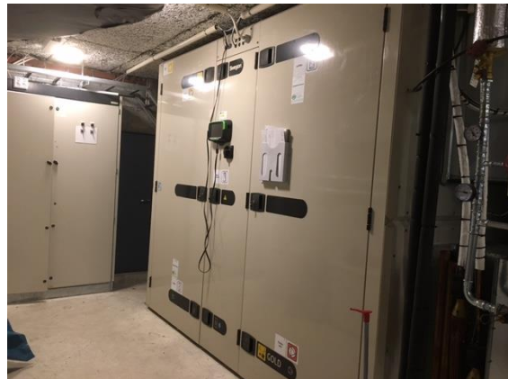
Bilde 8. Rådhuset, nytt hoved-ventilasjonsaggregat med integrert kjøling.
