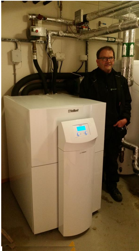
Bilde 14. Varmepumpe jord til vann, Kveldheim eldreboliger.
