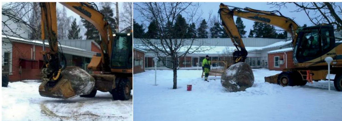
Suuri kaivinkone siirsi Sydänten kiven Sopukan pihalle ja asetteli sen paikoilleen. Oleskelupiha sai seuraavana kesänä ikkunapäättynsä ulko-oven ja katetun terassin (vrt. edellinen kuva). (Kuva: Helena Raatikainen)
