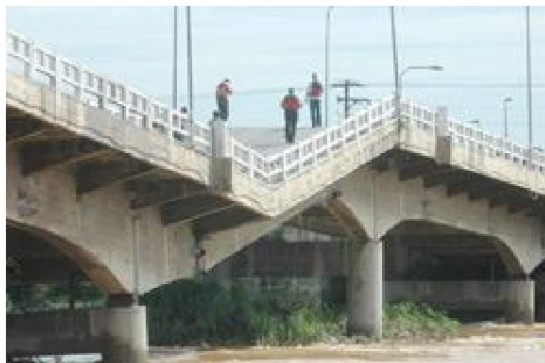
Figura 1 – Ponte General Dutra danificada. Campos, RJ. (Fonte: www.campos.rj.gov.br )
