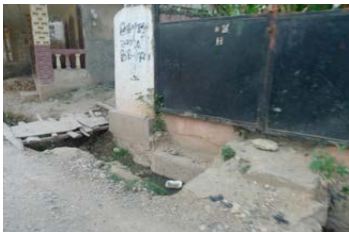
Images 35 et 36. Certaines rues du quartier montrent une partie d'un réseau d'égout en très mauvaises conditions. Photo: Teresa Tapada
