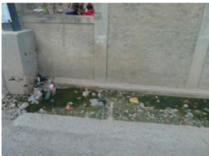
Images 37 et 38. Certaines rues du quartier montrent un réseau d'égout en très mauvaises conditions. Photo: Teresa Tapada
