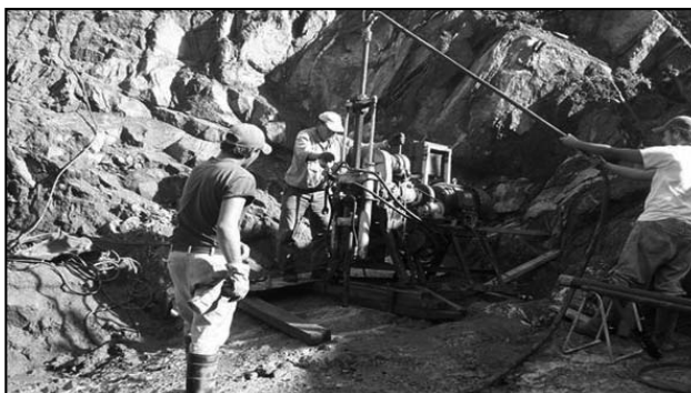
Figura 6. Progresiva 130 m. Sondeo complementario SC1. Perforación con extracción continua de testigos en el área del pie de presa sobre margen derecha (Actual Bloque 7).
