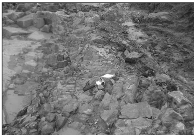
Figura 6. Área de estribo de margen derecha. Dique de rocas pegmatíticas rosadas en el plano de fundación previo a las tareas de saneamiento del contacto con rocas de composición gneissica. Se observa buena calidad geomecánica de la matriz rocosa pero con intensa presencia de fisuras, en parte rellenas de arcillas.
