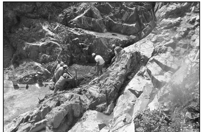
Figura 14. Proceso de hormigonado de reemplazo durante el saneamiento de zonas de alteración con presencia de cizalla en rocas de composición gneissica tonalítica cercanas al contacto gneiss - pegmatita.
