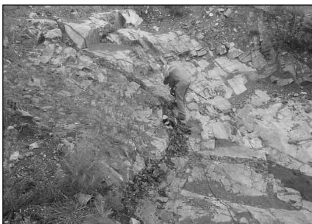
Figura 7. Sector demarcado para limpieza y calafateo de material muy fisurado con parcial presencia de arcillas plásticas rellenasdo fisuras entre progresivas 170 a 180.
