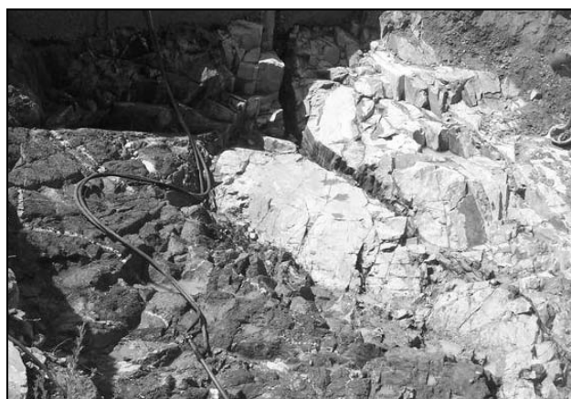
Figura 8. Vista del sector anterior (Figura 7) una vez finalizada la tarea de limpieza y previo al hormigonado de protección.
