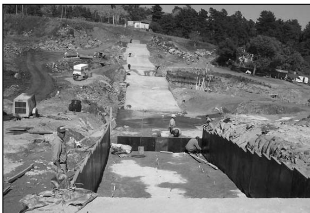
Figura 18. Zócalo de apoyo de la presa o plinto. Vista general desde el estribo de margen derecha de la totalidad del zócalo de apoyo. En primer plano se observa la colocación de los módulos para la construcción del bloque 10 de la presa.
