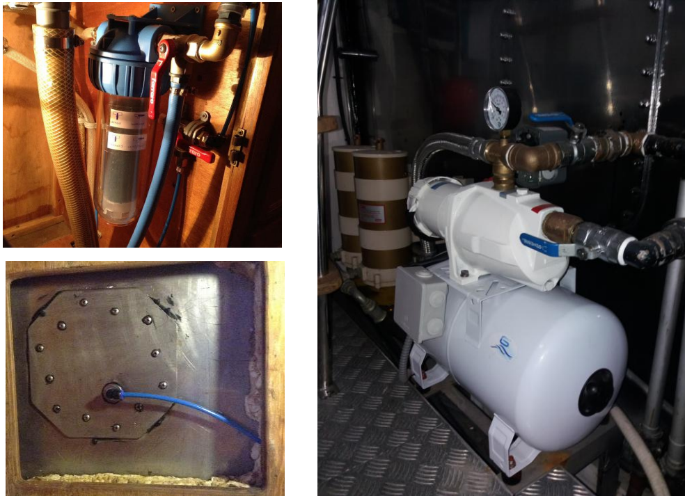
Fig. 4. 116. Circuit i bomba d'aigua dolça (Font: pròpia)
