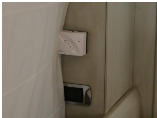
Fig. 4. 124. Termòstat (Font: pròpia)
