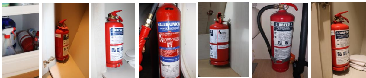
Fig. 4. 47. Extintors (Font: pròpia)
