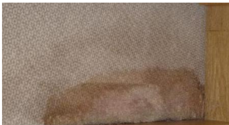
Fig. 4. 107. Moqueta en mal estat (Font: pròpia)
