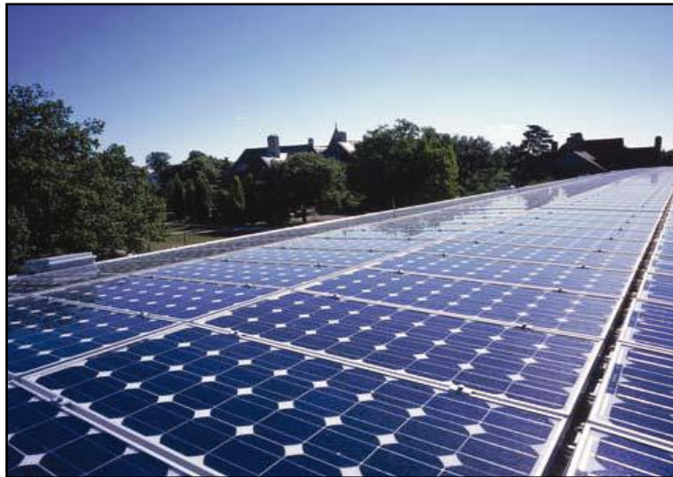
Figura 4 Obtención de energía a través de placas solares.
