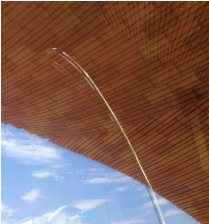
FIG. 65 - DETALLE DE LA GRIETA EN LA PARTE SUPERIOR DEL VIDRIO. FUENTE: VIDRES BERNI.
