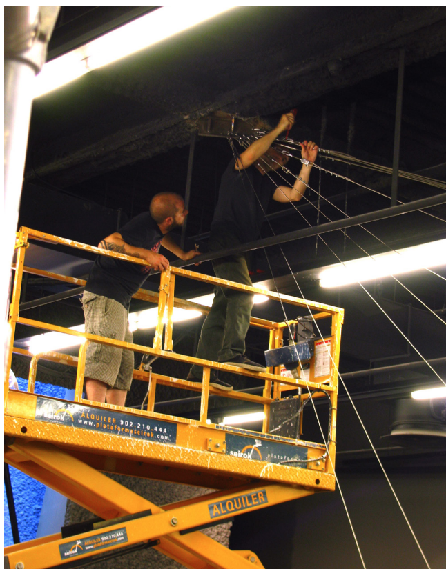
Figura 5. Proceso de ajuste de los cables en obra por los técnicos de GROF, en uno de los cuatro apoyos.
