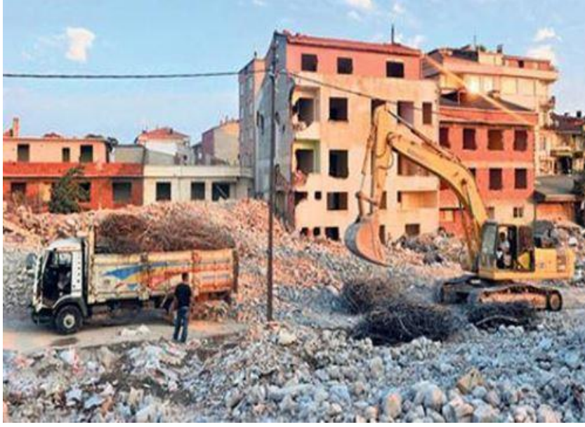
Şekil 9: Kentsel dönüşüm çalışmaları ve inşaat atıkları – molozlar (URL-13 2017)
