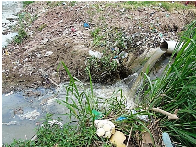
Figura 5. Vertido de aguas negras en los mercados de la 1ª Avenida de Comayagüela (Año 2017). Elaboración Propia
