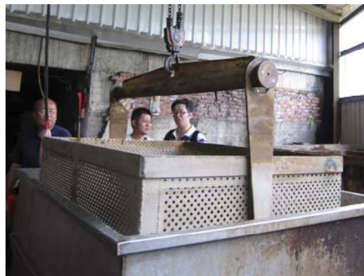
67. Estanque automático de acero inoxidable.
