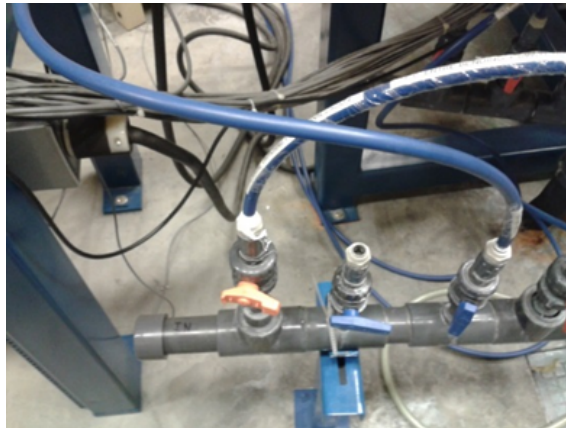
Figura 3.14: Control del circuito de refrigeración de agua para el soporte de reacción.
