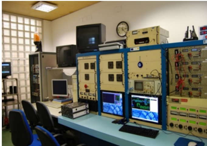
Figura 3.19: Sala de control del acelerador
